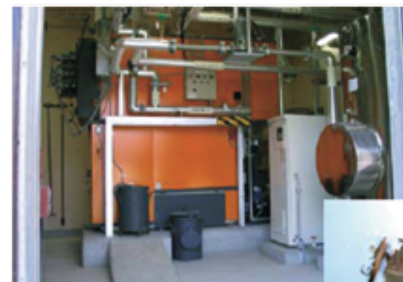
▲チップボイラー
